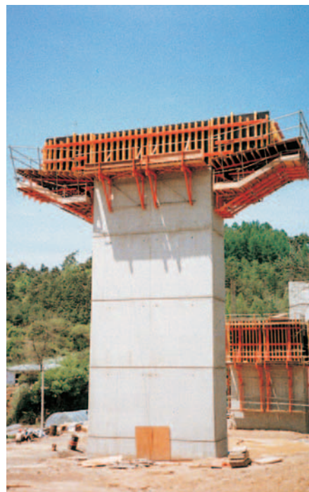
Contrafforte PERI SB-2 che realizza la piattaforma di sostegno di un pulvino.
